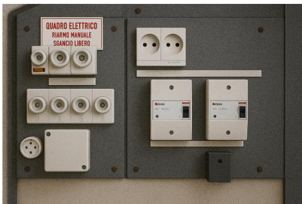
Figura 8 - quadro elettrico con lastre in cemento-amianto
