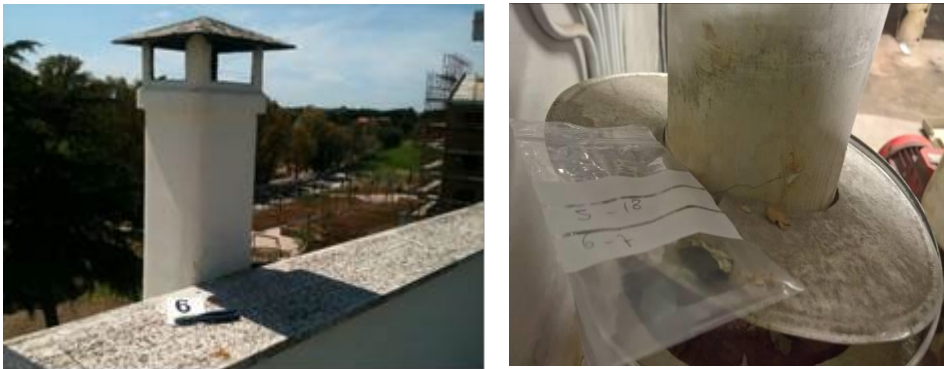
Figure 40 - immagine dei punti di prelievo: canna fumaria (sx) e coibente tubazione (dx)
