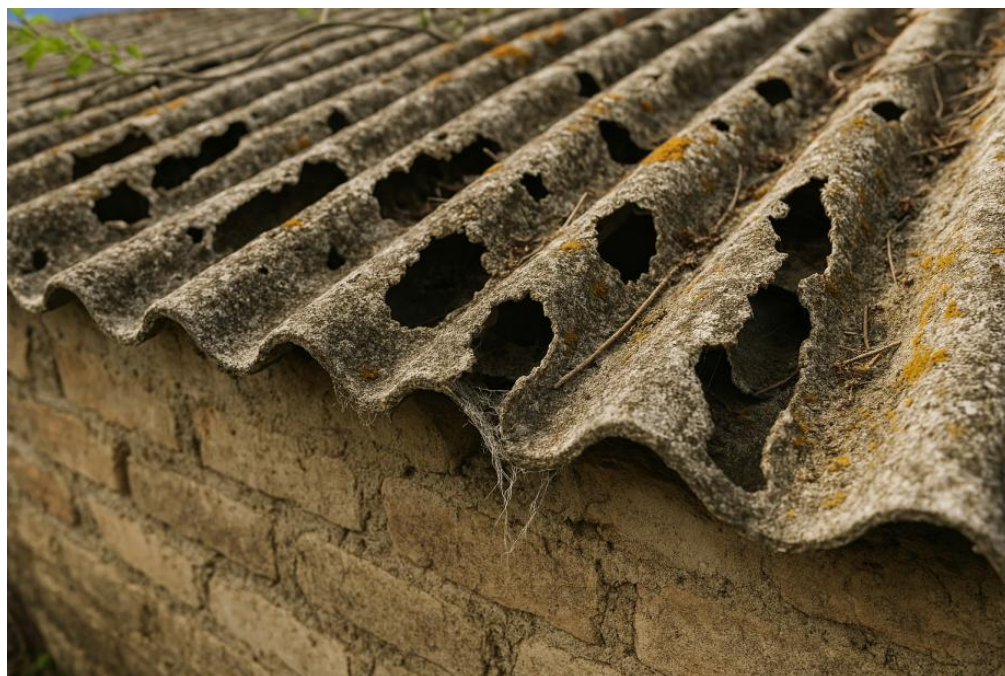
Figura 31 - materiale contenente amianto in copertura, originariamente compatto, degradato a tal punto da essere diventato fonte di cospicuo rilascio di fibre
